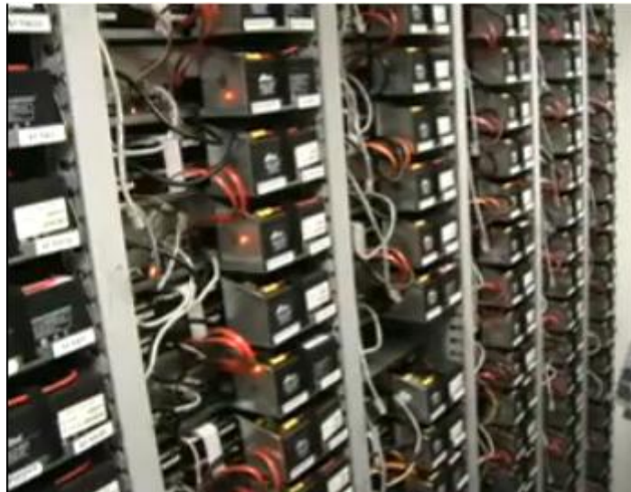
Google Racks nebeneinander
